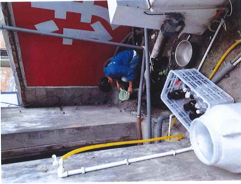
污水处理设施废水出口监测点 FS2
