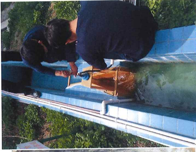
污水处理设备出口监测点 FS2
