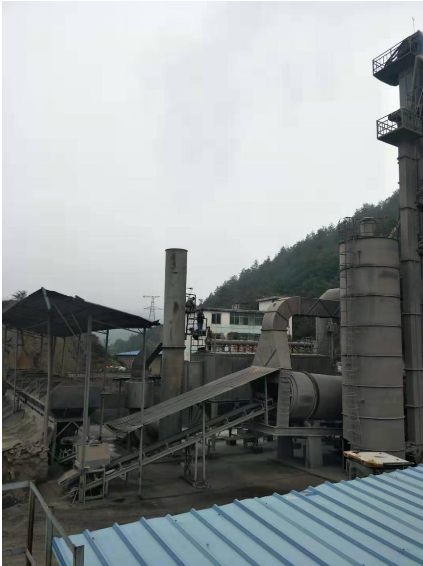
旋风+布袋二级除尘净化+活性炭纤维吸附处理设施 排气筒出口废气监测点 FK1 、FG1
