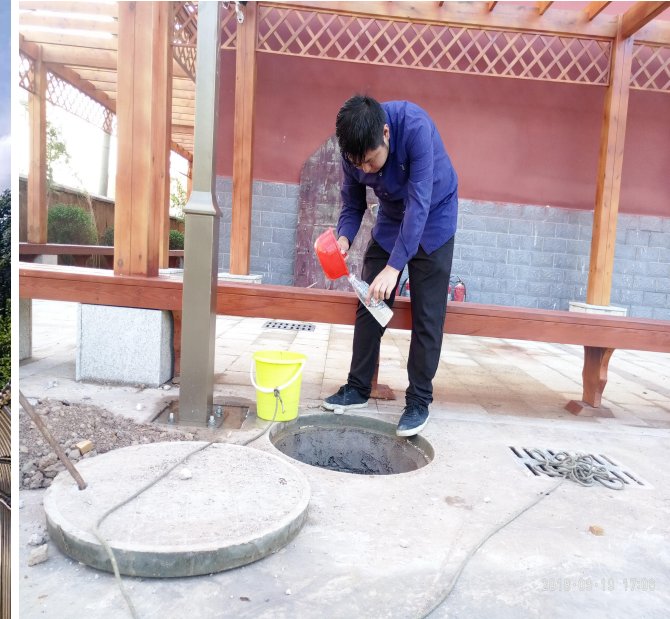
废水监测现场图片
