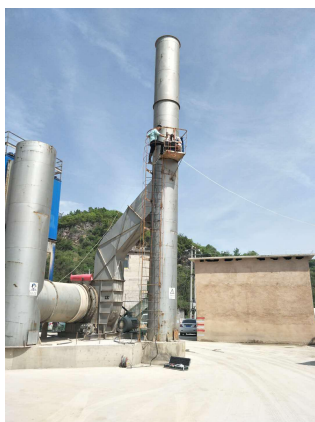
燃油锅炉监测点 FK1
