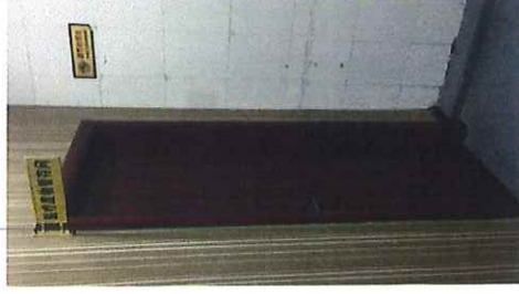
医疗废物暂存间
